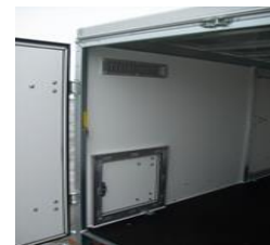
Lüftungsschieber, Service Tür
