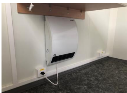
Elektroheizung unter Tisch
